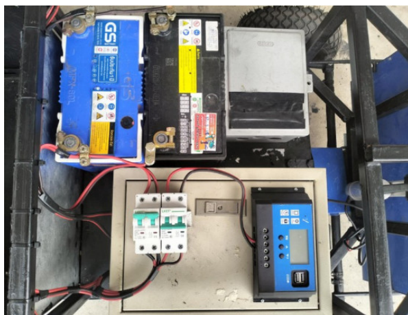
รูปที่ 4 การต่ออุปกรณ์ระบบผลิตพลังงานไฟฟ้าจากเซลล์แสงอาทิตย์
