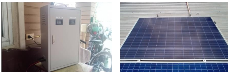
รูปที่ 5 กล่องควบคุม และเซลล์แสงอาทิตย์ที่ติดตั้งทดสอบ
