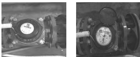
รูปที่ 9 มาตรวัดปริมาณการจ่ายน้ำป้อนเข้าหม้อไอน้ำ
