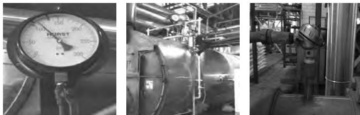
รูปที่ 3 เกจวัดแรงดันหม้อไอน้ำและเครื่องวัดอุณหภูมิ
