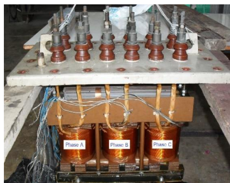
รูปที่ 1 การติดตั้งหัววัดเทอร์โมคัปเปิล เพื่อวัดอุณหภูมิตำแหน่งต่างๆ ภายในหม้อแปลงแบบแช่น้ำมัน
