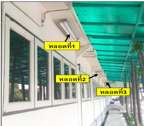
รูปที่ 2 หลอดแอลอีดีแบบ T8 ขนาด 18W จำนวน 3 หลอดที่มีอยู่แต่เดิม
