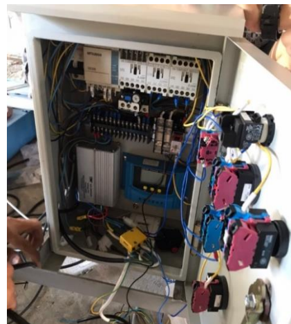
รูปที่ 12 กล่องควบคุมมอเตอร์และชาร์จเจอร์เข้ากับอุปกรณ์ไฟฟ้าอื่นๆ
