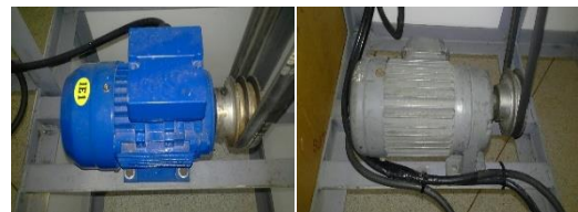
รูปที่ 8 มอเตอร์ไฟฟ้า
