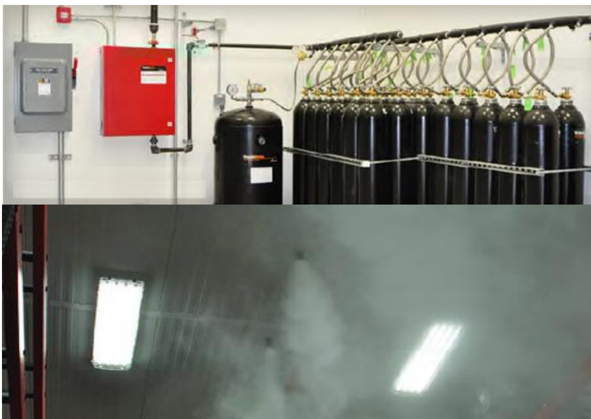
รูปที่ 6 แสดงการทำงานใช้ระบบดับเพลิงคู่ ระหว่างน้ำและไนโตรเจน[3]
