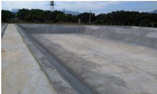
(ข) บ่อหมักแบบพื้นคอนกรีต
