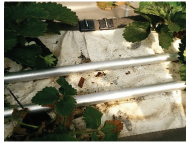
(ง) ท่อน้ำเย็น
