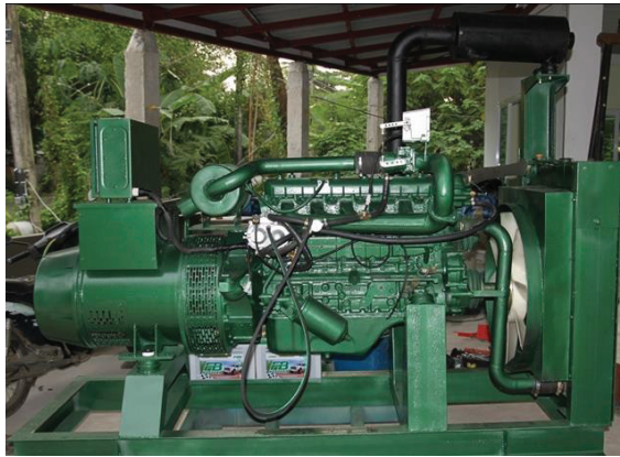
รูปที่ 3 เครื่องกำเนิดไฟฟ้าแก๊สชีวภาพ
