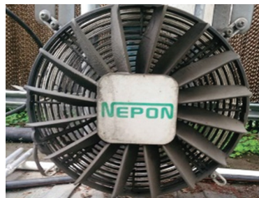
(ข) พัดลมระบายอากาศ
