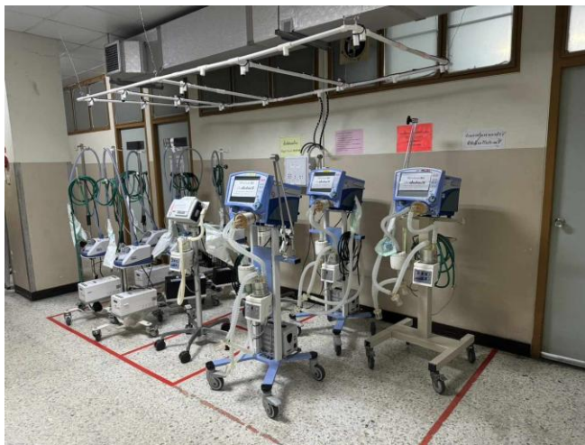
ภาพที่ 2 ลักษณะของการติดตั้งชุดอุปกรณ์ที่หน้าห้องฉุกเฉิน
