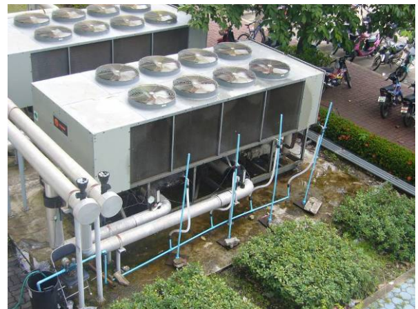
รูปที่ 12 ละอองน้ำที่ถูกพ่นโดยรอบเครื่องปรับอากาศ
