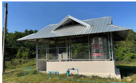
รูปที่ 1 โรงเรือนควบคุมระบบปั้มน้ำบาดาลโรงพยาบาลพ่อท่านคล้ายจากสิทธิ์
