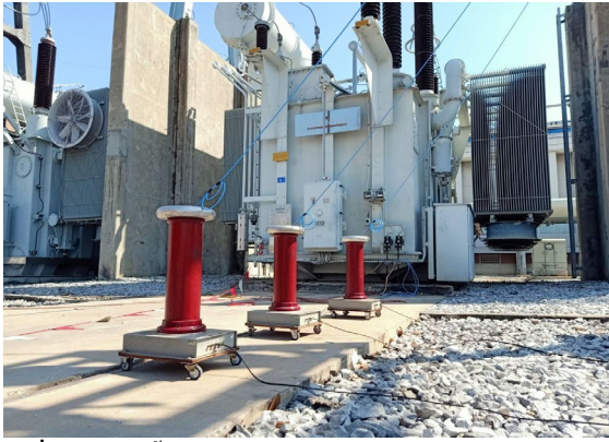
รูปที่ 8 การติดตั้งโวลต์เดจดีไวเซอร์จำนวน 3 ตัวสำหรับการวัดขนาดและรูปคลื่นของแรงดันฝั่งขดลวดคดียภูมิ (22 kV)
