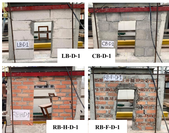
รูปที่ 19 การวิบัติของผนังก่ออิฐรูปแบบที่ 4
