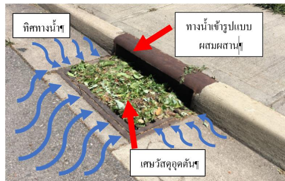
รูปที่ 2 การอุดตันทางน้ำเข้า
