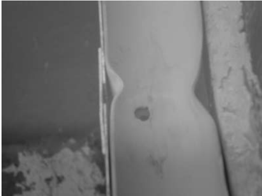
ภาพที่ 8 รางรวบรวมน้ำควบแน่นทางด้านข้างหม้อต้มซึ่งเจาะรูเพื่อปล่อยน้ำตกกระทบบใบพัดด้านล่าง
