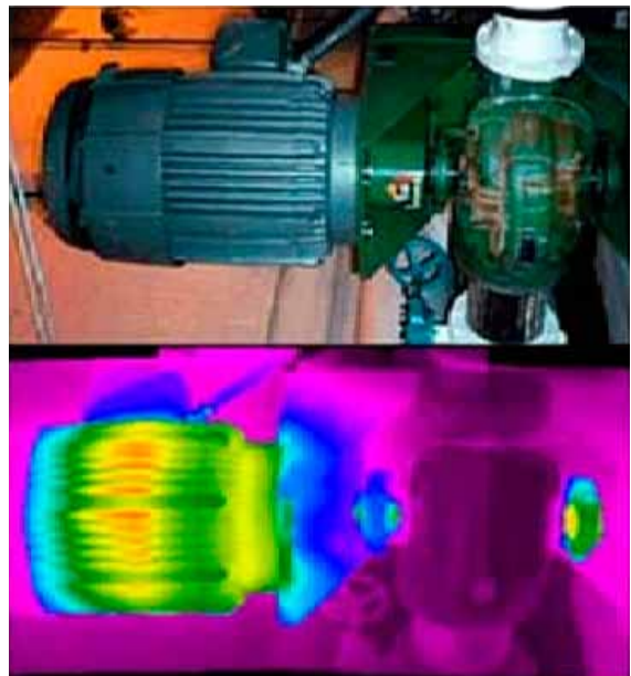
รูปที่ 13 ตัวอย่างภาพถ่ายทางความร้อนจากมอเตอร์ [40]
