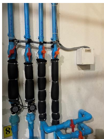
(ก) ท่อที่มีการติดตั้งอุปกรณ์ IoT
