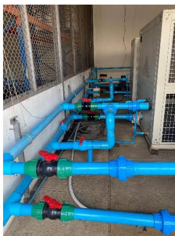
(ข) ท่อน้ำหล่อเย็นหลังปรับปรุง
