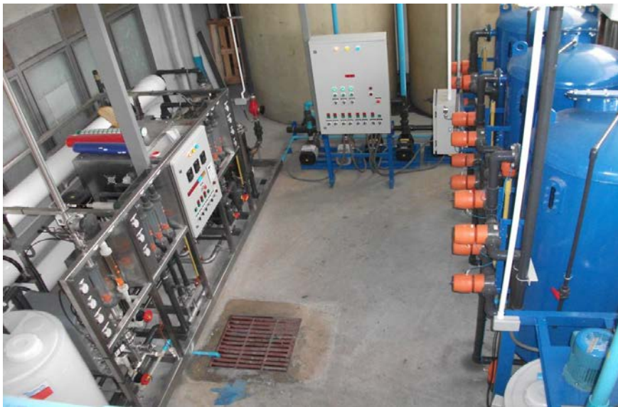
รูปที่ 4 ระบบผลิตน้ำบริสุทธิ์ EDI ขนาด 3 m 3 /hr ที่ติดตั้งแล้วเสร็จ
