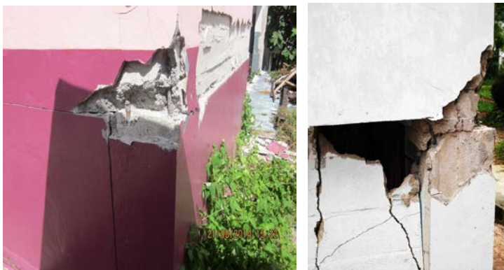
รูปที่ 3 ความเสียหายบริเวณรอยต่อการก่อสร้างของอาคารเรียน โรงเรียนแม่ลาววิทยาคม [7]
