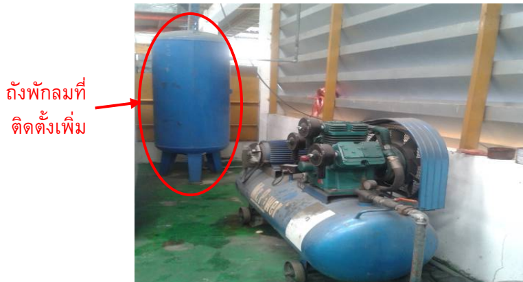
รูปที่ 12 เพิ่มถังพักลมในระบบอัดอากาศ
