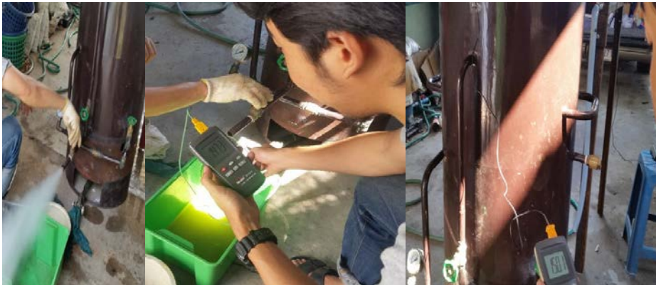
รูปที่ 7 ผลการตรวจสอบสถานะของไอน้ำที่ผลิตได้จากหม้อไอน้ำ
