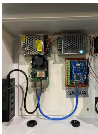
(ข) อุปกรณ์ภายในตู้ควบคุม
