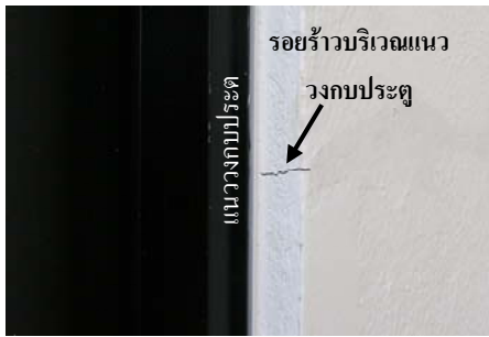
รูปที่ 2 รอยร้าวบริเวณแนววงกบประตู
