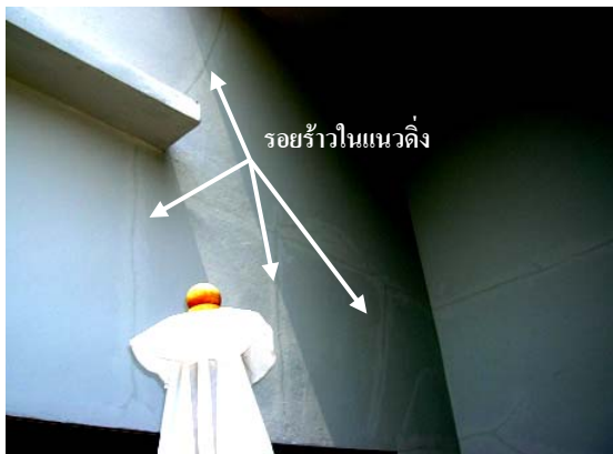
รูปที่ 4 รอยร้าวในแนวตั้งด้านนอกของอาคาร
