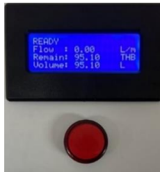
รูปที่ 25 ค่าปริมาณน้ำที่วัดได้จากเครื่องควบคุมที่สร้าง ขึ้น หลังจากใช้ไป 5 ลิตร คงเหลือ 95.10 ลิตร
