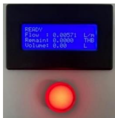
รูปที่ 16 ไฟแจ้งเตือนติดค้างเมื่อปริมาณน้ำที่สามารถใช้ได้เท่ากับ 0 ลิตร
