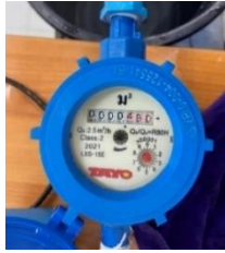
รูปที่ 24 หลังจากใช้น้ำไป 5 ลิตร ค่าตัวเลขจากมิเตอร์ น้ำมีค่า 490 ลิตร
