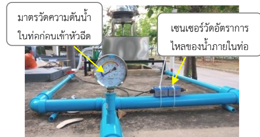
รูปที่ 5 ติดตั้งมาตรวัดความดันน้ำและมาตรวัดอัตราการไหลที่ตำแหน่งก่อนจ่ายน้ำเข้าหัวฉีด
