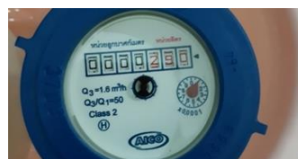
รูปที่ 21 หลังจากใช้น้ำไป 12 ลิตร ค่าตัวเลขจากมิเตอร์น้ำมีค่า 290 ลิตร
