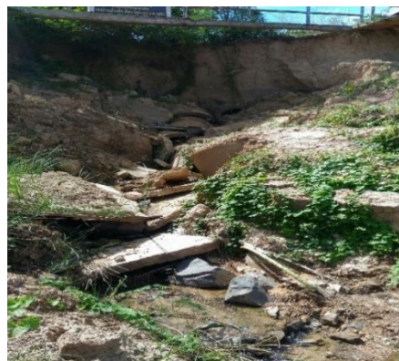
รูปที่ 13 ความเสียหายของเชื่อนป้องกันตลิ่งที่บ้านด่านใหม่ ต.โขงเจียม อ.โขงเจียม จ.อุบลราชธานี
