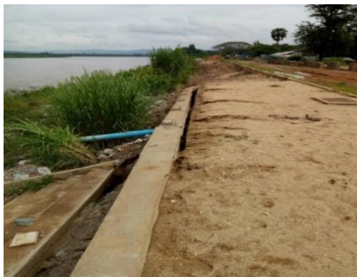
รูปที่ 11 ความเสียหายของเชื่อนป้องกันตลิ่งที่บ้านห้วยลึก ต.ม่วงยาย อ.เวียงแก่น จ.เชียงราย
