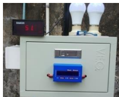
รูปที่ 6 ชุดวัดและแสดงผลค่าทางไฟฟ้าที่เครื่องกำเนิดไฟฟ้าผลิตได้
