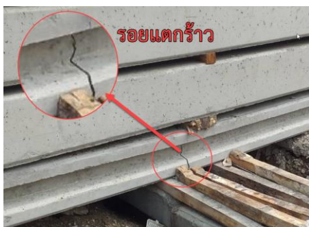
รูปที่ 6 ความเสียหายของเสาเข็ม
