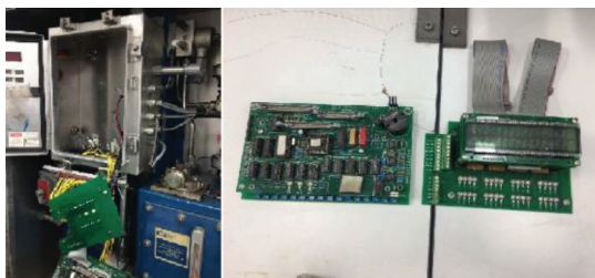
รูปที่ 2 ชุดควบคุมหล่อลื่นแบบละอองน้ำมัน
