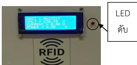
รูปที่ 18 ค่าพลังงานไฟฟ้าที่ใช้ได้มีค่ามากกว่าหนึ่งหน่วย หลอด LED ดับ
