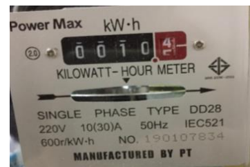
รูปที่ 22 ค่าการใช้พลังงานไฟฟ้าที่อ่านได้จาก กิโลวัตต์-ชั่วโมง มิเตอร์ เมื่อครบกำหนดมีค่า 10.44 หน่วย
