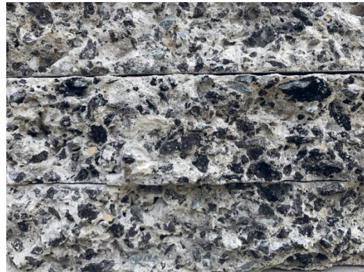
รูปที่ 9 แผ่นกระเบื้องคอนกรีตปูพื้นผสมเศษถนนยางมะตอยเก่าอัตราส่วน A2.5 ที่วิบัติจากแรงดัด
