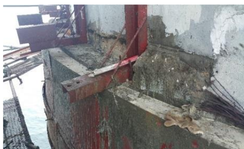
รูปที่ 15 ลักษณะเสาอาคารหลังจากได้ซ่อมแซมด้วยคอนกรีตใต้น้ำแล้ว
