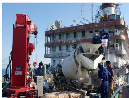
รูปที่ 11 เครื่องจักร วัสดุ และเครื่องมืออุปกรณ์ ถูกขนส่งลำเลียงมายังหน้างานในพื้นที่ที่ได้จัดเตรียมไว้
