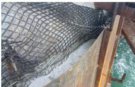
รูปที่ 13 วัสดุเสริมแรงที่ประยุกต์จากวัสดุเสริมแรงของงานดินมาใช้เป็นวัสดุเสริมในเสาคอนกรีตเพื่อป้องกันการแตกร้าว
