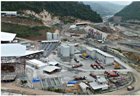
รูปที่ 20 โรงผสมคอนกรีตขนาด 480 ลบ.ม ต่อชั่วโมง
