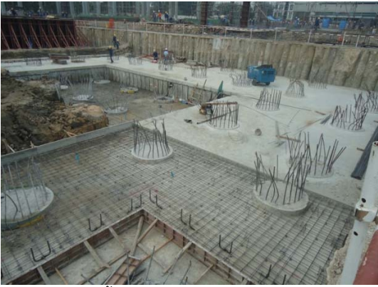
รูปที่ 4 การเพิ่มพื้นคอนกรีตไร้คานใต้ฐานรากแพ เพื่อช่วยรับน้ำหนักคอนกรีตสดขณะเทคอนกรีต
