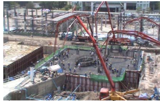
รูปที่ 10 การเทคอนกรีตฐานรากแพโดยใช้ปั๊มคอนกรีต จำนวน 5-6 ตัว
