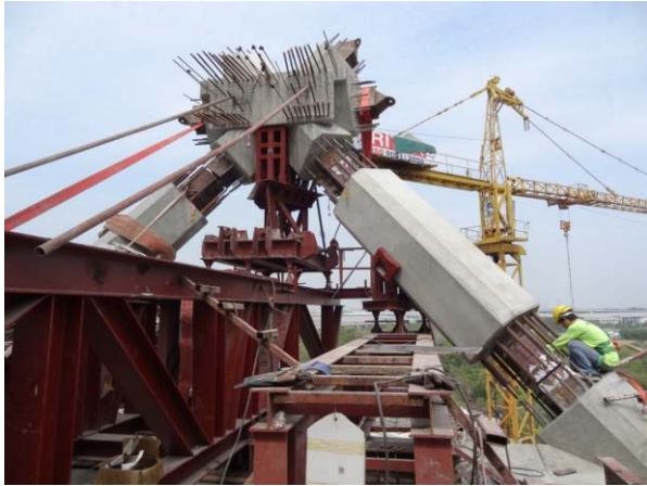
รูปที่ 21 การตรวจวัดตำแหน่งโครงเหล็กชั่วคราวให้ถูกต้องและตั้งเผื่อค่าขดเคयरการแอ่นตัวของโครงเหล็กให้การปรับระยะละเอียดด้วยสกรูแจ็คนอยที่สุต เพื่อให้ชิ้นส่วนคอนกรีตสำเร็จรูปคานและเสาเอียงอยู่ในตำแหน่งที่ถูกต้อง
