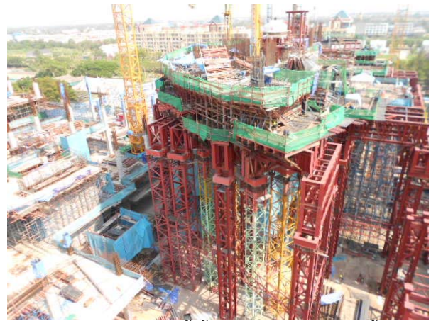
รูปที่ 13 โครงสร้างเหล็กตั้งขึ้นจากฐานรากเพื่อรองรับน้ำหนัก
