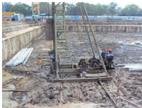
รูปที่ 3 การตอกเสาเข็มคอนกรีตอัดแรง และสร้างพื้นคอนกรีตไร้คานช่วยรับน้ำหนักคอนกรีตสดขณะเทคอนกรีตฐานรากแพ
