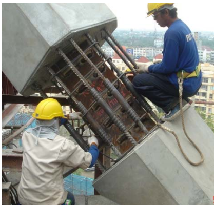
รูปที่ 23 การเชื่อมต่อเหล็กแผ่นที่แกนกลางด้วยการเชื่อมลวดเชื่อมไฟฟ้าและทดสอบ UT ทุกรอยเชื่อม ก่อนที่จะต่อเหล็กเสริมข้ออ้อยด้วยข้อต่อเหล็กชนิด Cold Pressed Coupler
