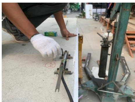
รูปที่ 11 การติดตั้ง Strain Gage
