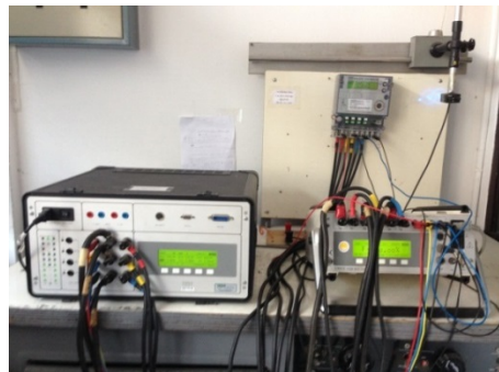
ภาพที่ 2 การต่อมิเตอร์ไฟฟ้าเข้ากับ Phantom Load และ Standard Meter
