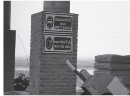
รูปที่ 2 ป้ายให้สวมแว่นตาและหน้ากากนิรภัยบริเวณพื้นที่ตัดเหล็ก
