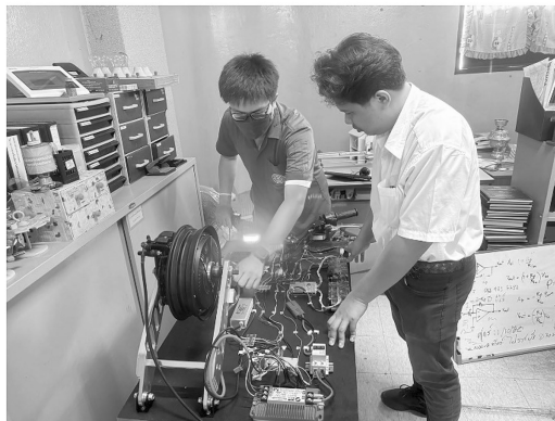
ภาพที่ 2 การต่อชุดฝึกการขับเคลื่อนทางไฟฟ้าโดยใช้มอเตอร์ไฟฟ้ากระแสตรงแบบไร้แปรงถ่าน
