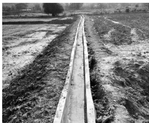
ภาพที่ 25 คูส่งน้ำคอนกรีตผสมน้ำยางพาราพร้อมใช้งานในพื้นที่แปลงนา
