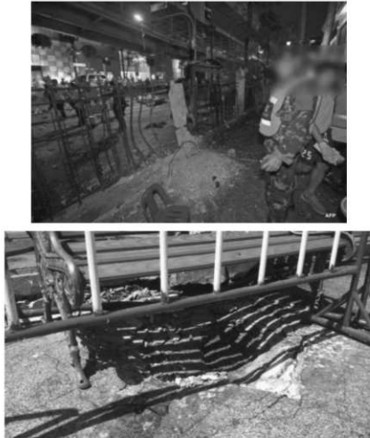
ภาพที่ 14 ความเสียหายที่เกิดขึ้นกับรั้วและพื้นคอนกรีตเสริมเหล็กบริเวณศาลท้าวมหาพรหม [16, 17]
