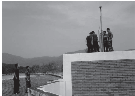
รูปที่ 4 สายอากาศและชุด Mesh Master ติดตั้งบนหลังคาแฟลตเพื่อทำการทดสอบการเชื่อมต่อแบบไร้สาย
