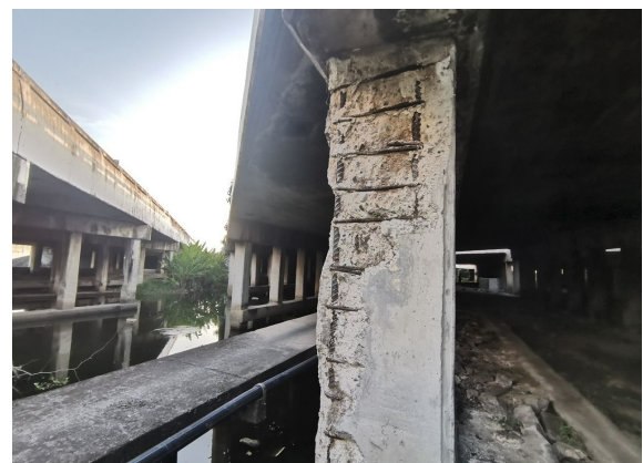
รูปที่ 1 : การแตกร้าวของคอนกรีตตอม่อสะพาน
