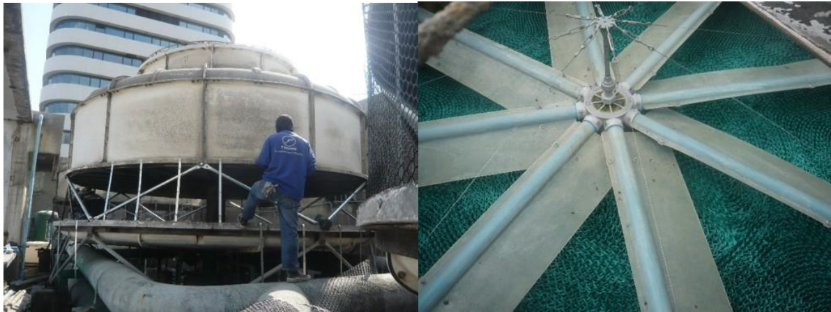
รูปที่ 3 Cooling Tower ขนาด 500 TR จำนวน 4 ชุดหลังติดตั้ง Sprinkler Pipe
