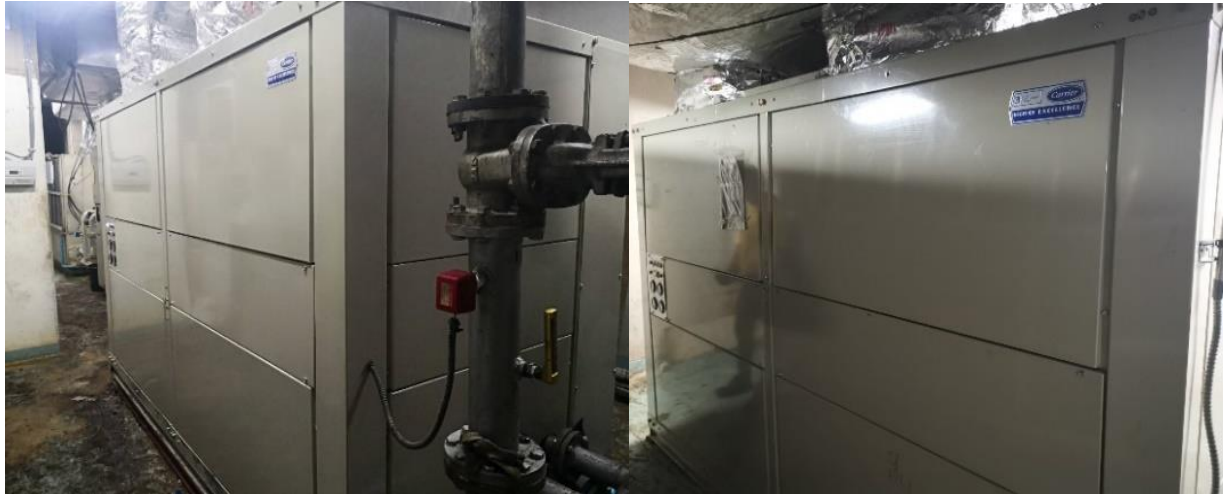
รูปที่ 4 แสดงเครื่องปรับอากาศ Package Water Cooled หลังจากดำเนินการแล้วเสร็จ
