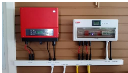
รูปที่ 3 ชุดควบคุมระบบผลิตกระแสไฟฟ้าพลังงานแสงอาทิตย์
