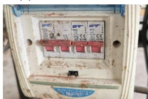
(ฉ) แผงควบคุม
