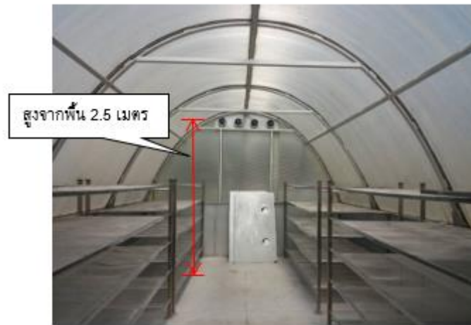
รูปที่ 4 ตำแหน่งการติดตั้งพัดลมพาอากาศร่อนออกจากห้องอบ
